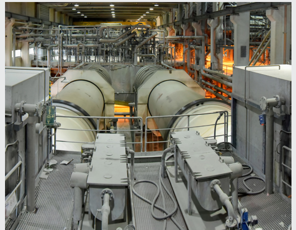
Systémy stlačeného vzduchu jsou důležitou součástí recyklace papíru.
