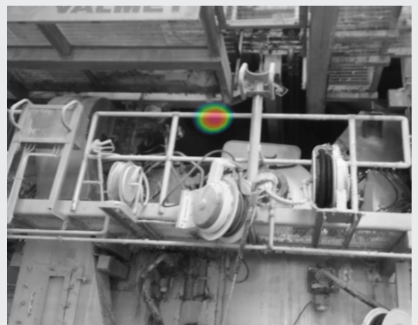
Kamera FLIR Si124 detekuje únik stlačeného vzduchu.
